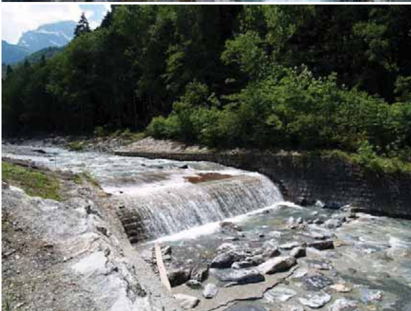
Fassung Engelberger Aa, Obermatt, Tirolerwehr und Tosbecken mit Überlauf, Blick aufwärts.
