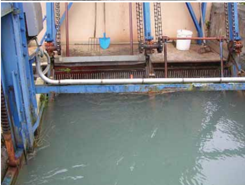
Einlaufrechen vor der Zentrale
