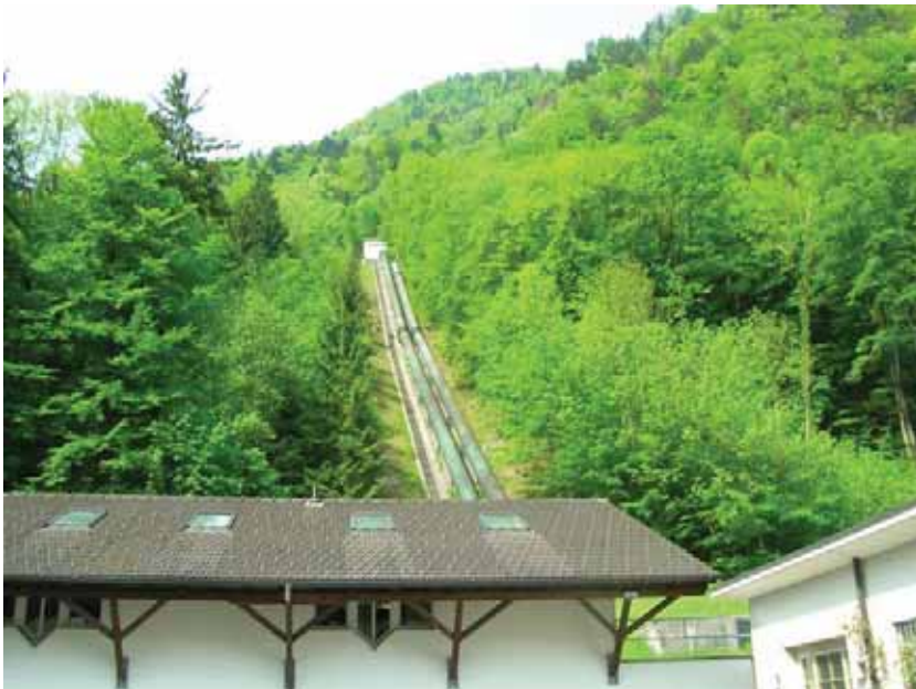
Druckleitung oberhalb Maschinenhaus des KW Dallenwil
