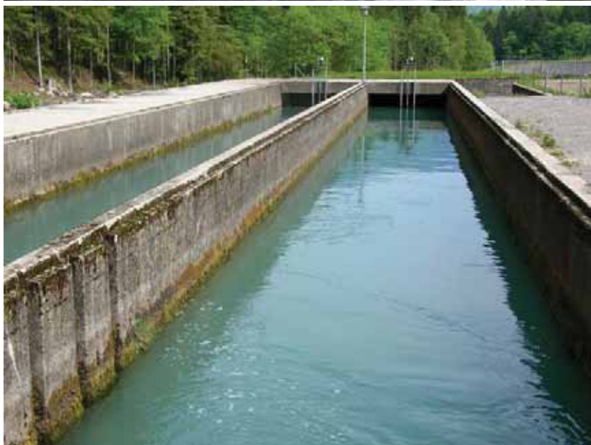
Sandfang der Fassung Engelberger Aa, Obermatt
