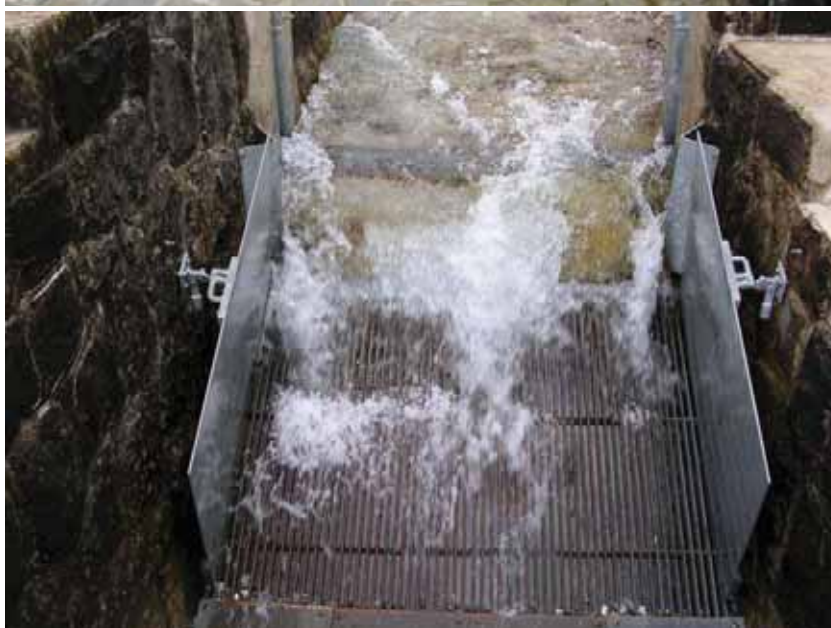
Verschliessbares Tirolerwehr der Fassung Arnibach oben
