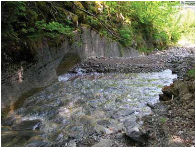
Fassung Gerbibach, Tirolerwehr
