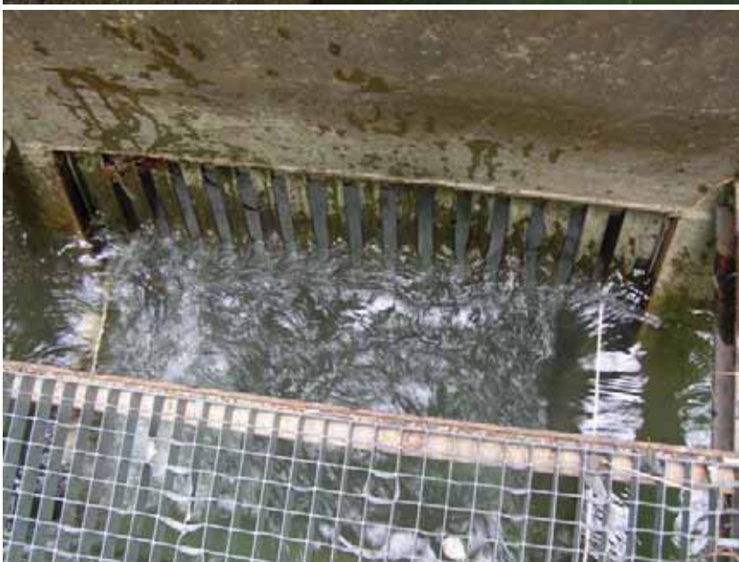
Einlaufrechen der Fassung Fallenbach
