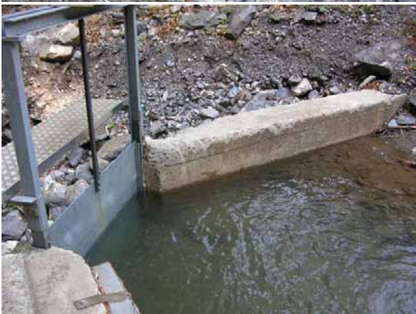
Schützenwehr der Fassung Eugeniebach unten
