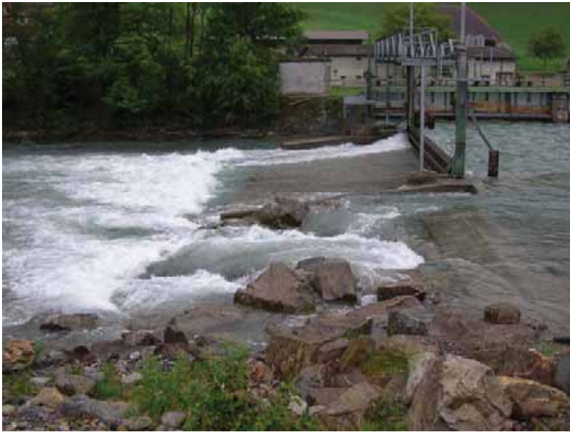
Schützenwehr der Fassung Engelberger Aa, Hostetten mit Fischeufstiegshilfe im Vordergrund
