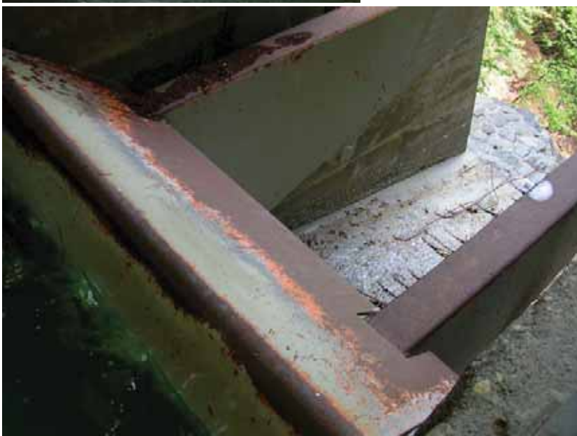
Ferngesteuerte, bewegliche Schütze der Fassung Gerlibach
