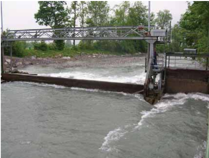
Schützenwehr und Spülschütz der Fassung Engelberger Aa, Hostetten
