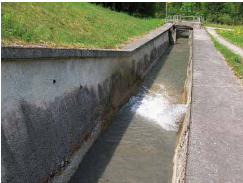
Unterirdischer Einlauf des Chaltibachs (wird dem Aus- gleichsbecken Obermatt zuge- führt)
