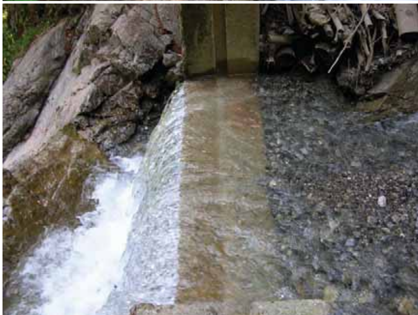
Fassung Luterseebach, Vorrichtung für Dammbalken (Fassung ausser Betrieb)
