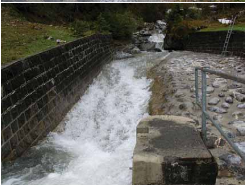
Einlaufbauwerk der Fassung Trüebenbach oben
