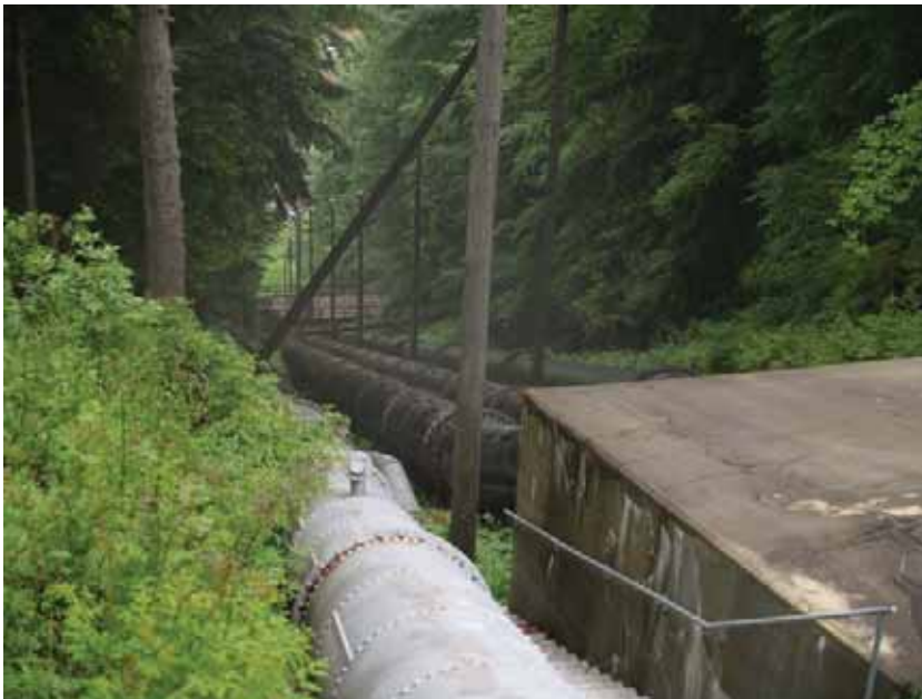
Druckleitungen oberhalb des KW Obermatt
