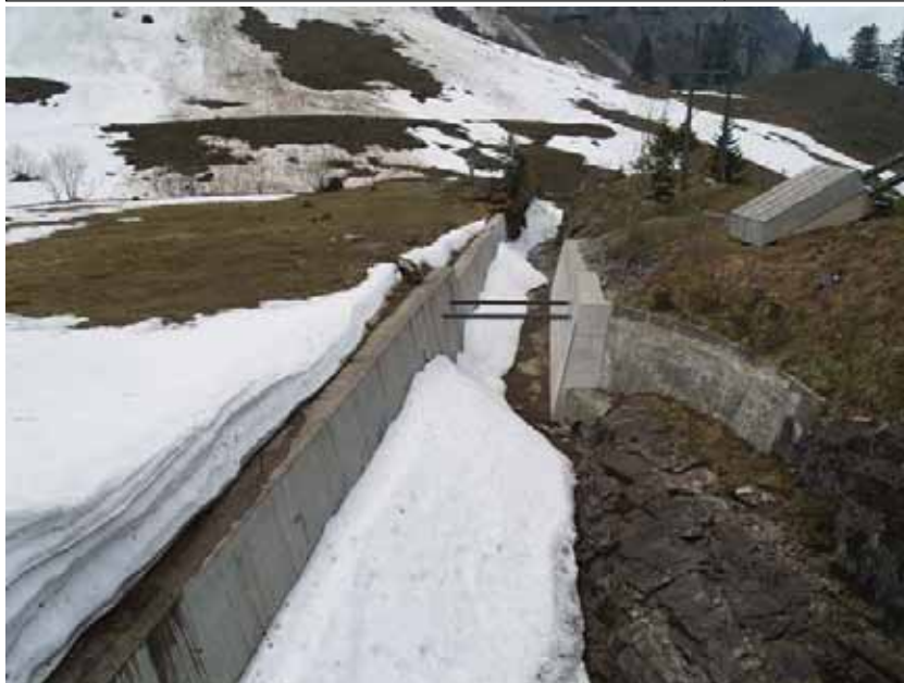
Restwasserstrecke (Überlauftrinne) unterhalb der Fassung Bannalpsee
