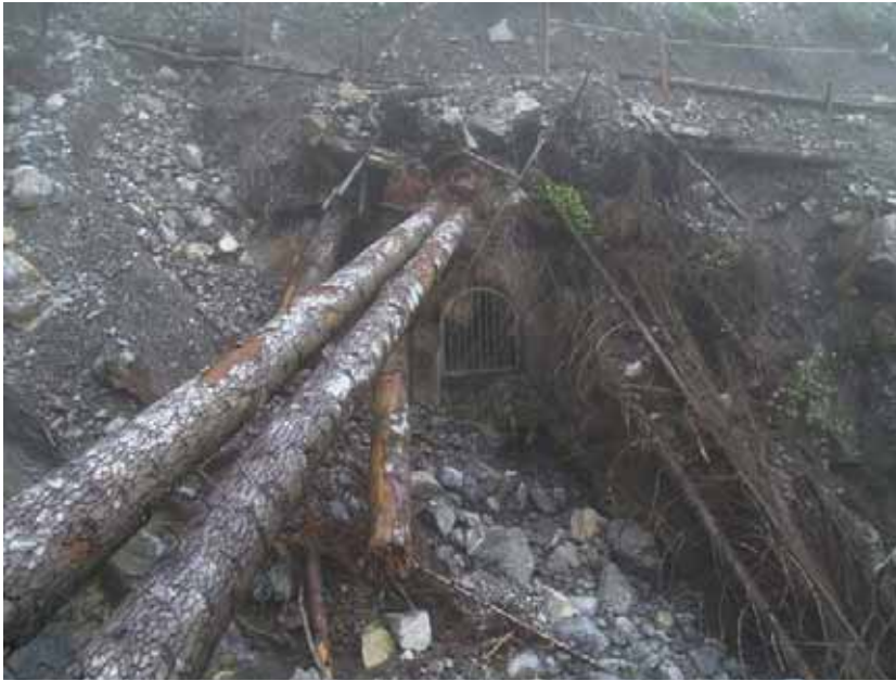
Durch die Hangrutschung beschädigter Spülstollen
