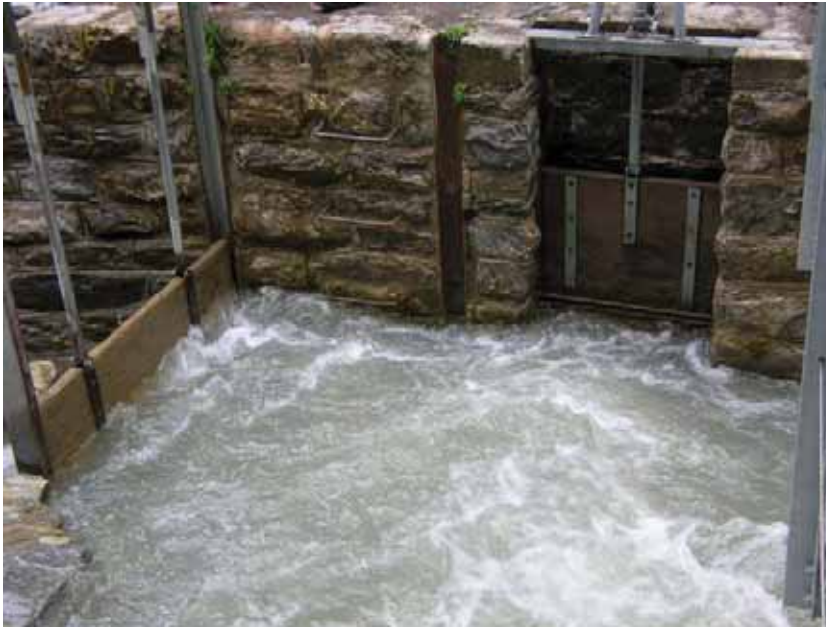
Abperrschütze (links) und Einlaufschütze (mitte) der Fassung Trüebenbach unten
