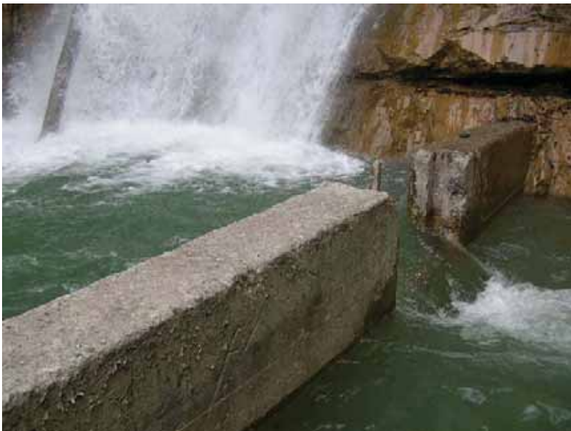
Wasserausleitung in Sandfang bei der Fassung Fallenbach
