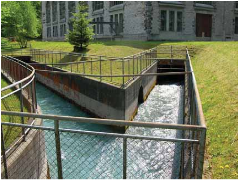
Turbinenauslass des KW Obermatt, EWL (wird dem Ausgleichsbecken Obermatt zugeleitet)
