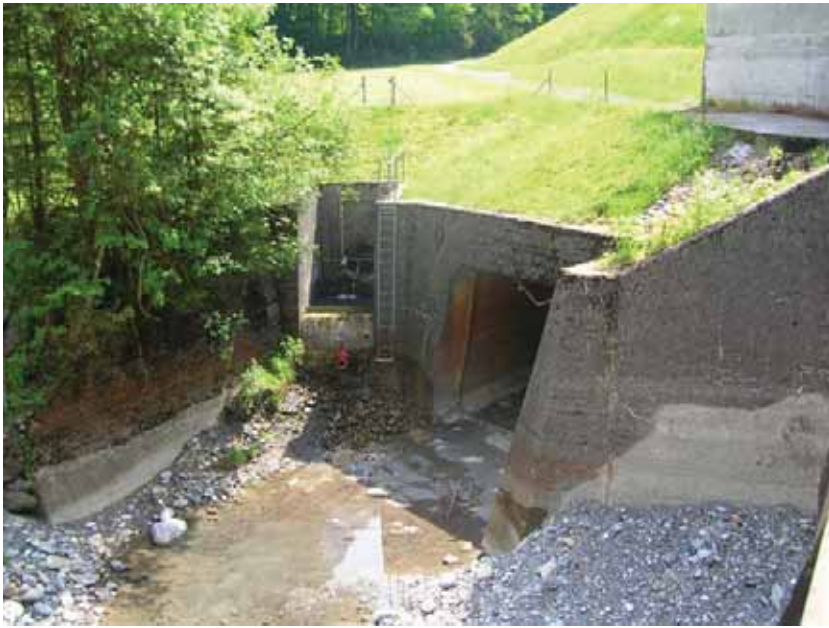
Grundablass und Spülstollen des Ausgleichbeckens Ober- matt
