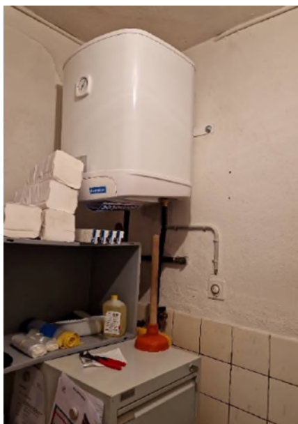
Elektrischer Boiler Erdgeschoss
