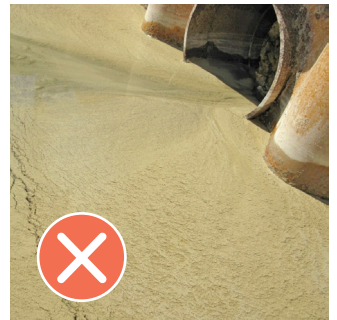
Schlammraum ist überfüllt, Leerung notwendig
