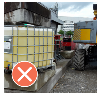
Auffangwanne fehlt, Abstand von Baumaschine zu gering
