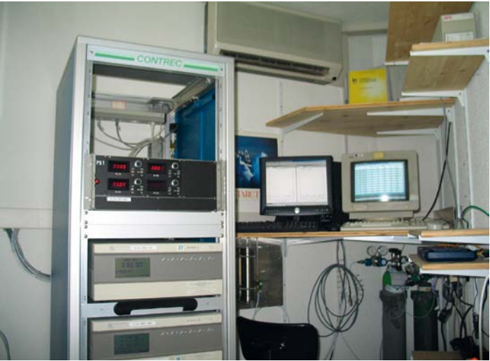
Luftmessstation am 2. Standort an der Engelbergstrasse in Stans.
