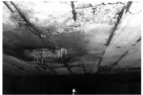
Legende: Betonschäden Decke Kanal (Foto: Amt für Mobilität)
