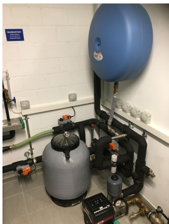
Foto Installation Filteranlage Wohnhaus Beckenried
